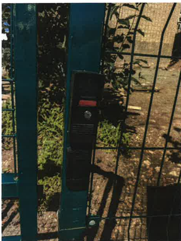
Фото 1.3 Наружное вызывное устройство перед основным входом на территорию
