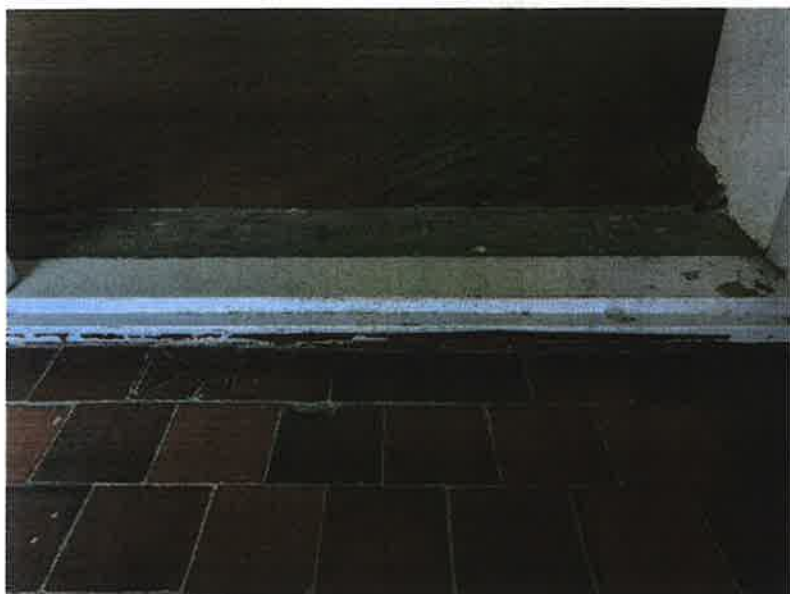
Фото 3.26 Порог двери от лестницы к холлу 3-го этажа
