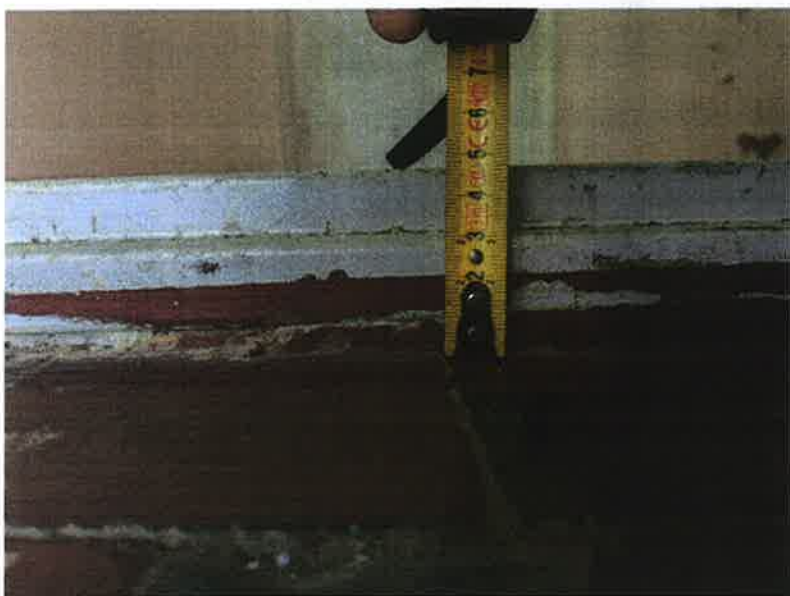
Фото 3.25 Порог двери от лестницы к холлу 3-го этажа
