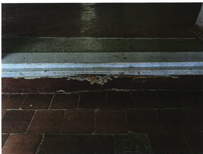
Фото 3.35 Порог двери от лестницы к холлу 4-го этажа
