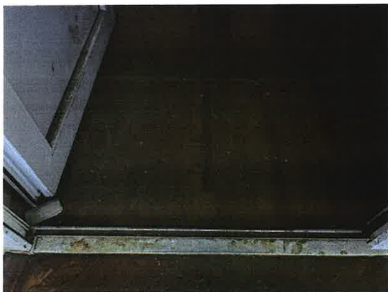
Фото 3.31 Порог двери в коридор 3-го этажа
