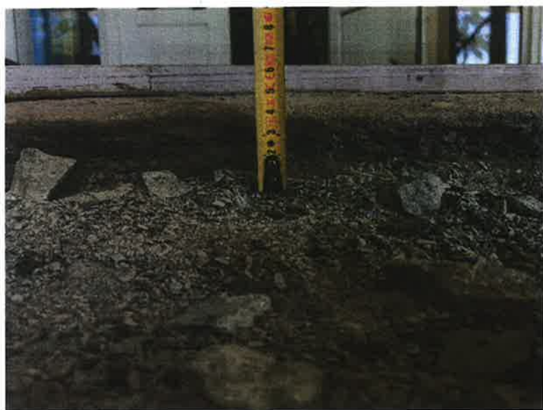
Фото 2.5 Порог входной двери
