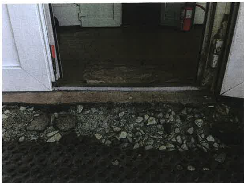
Фото 2.7 Порог входной двери
