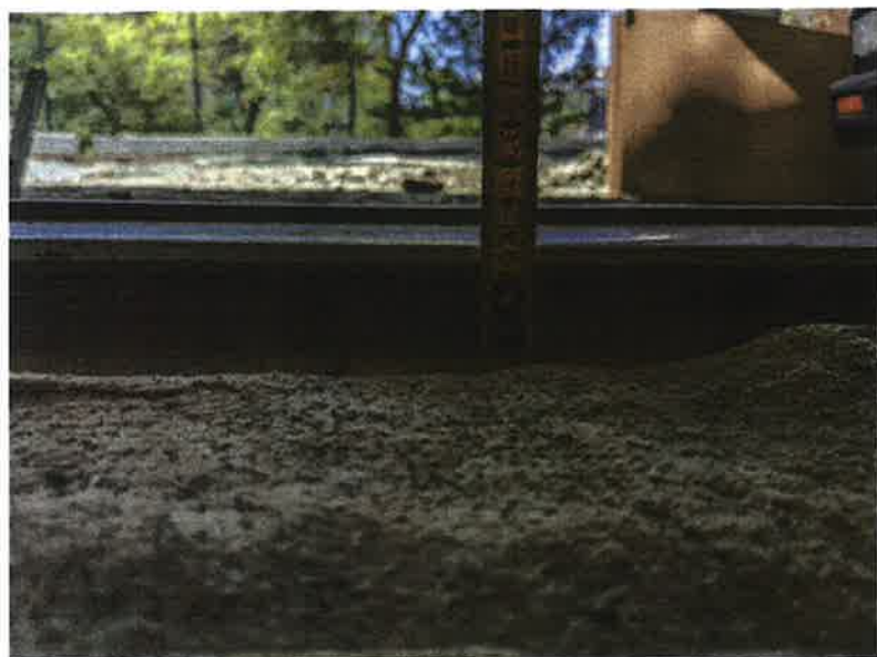
Фото 2.6 Порог входной двери
