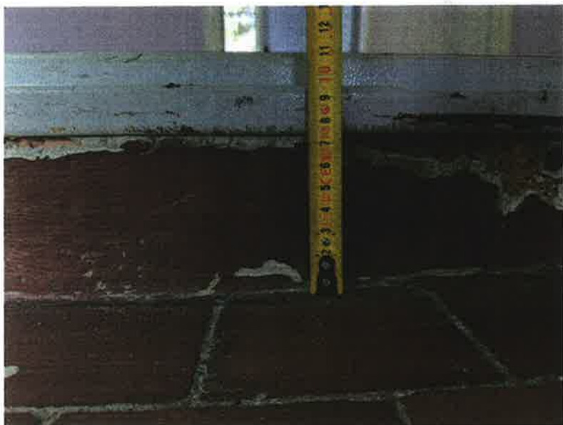
Фото 3.34 Порог двери от лестницы к холлу 4-го этажа
