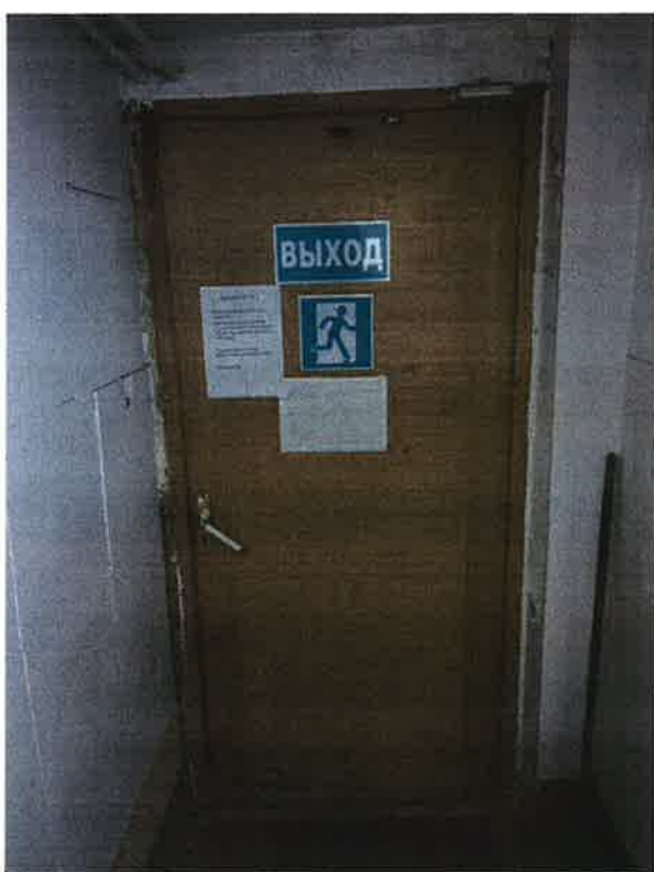
Фото 3.23 Дверь в тамбур эвакуационного выхода
