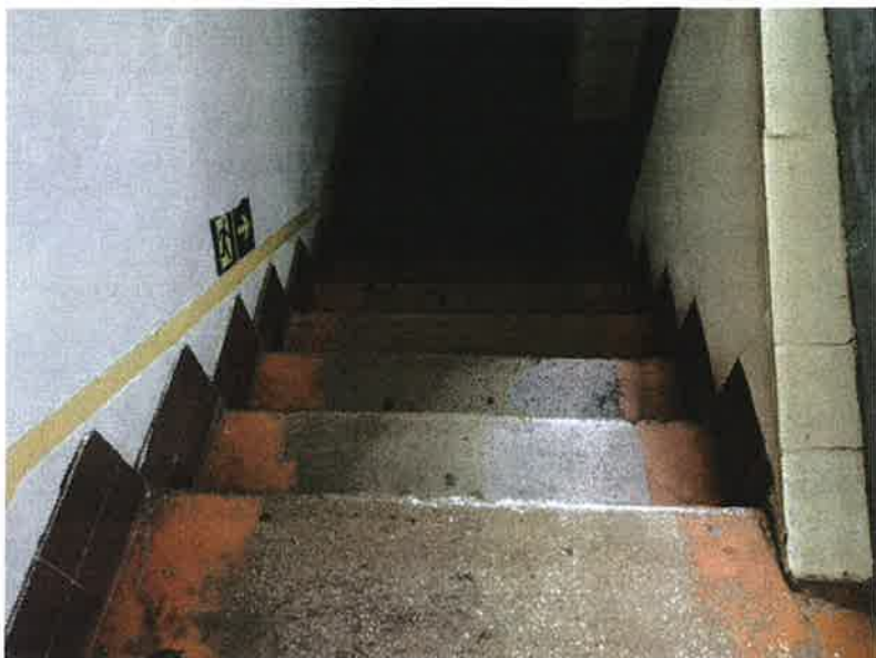
Фото 3.22 Лестница к эвакуационному выходу
