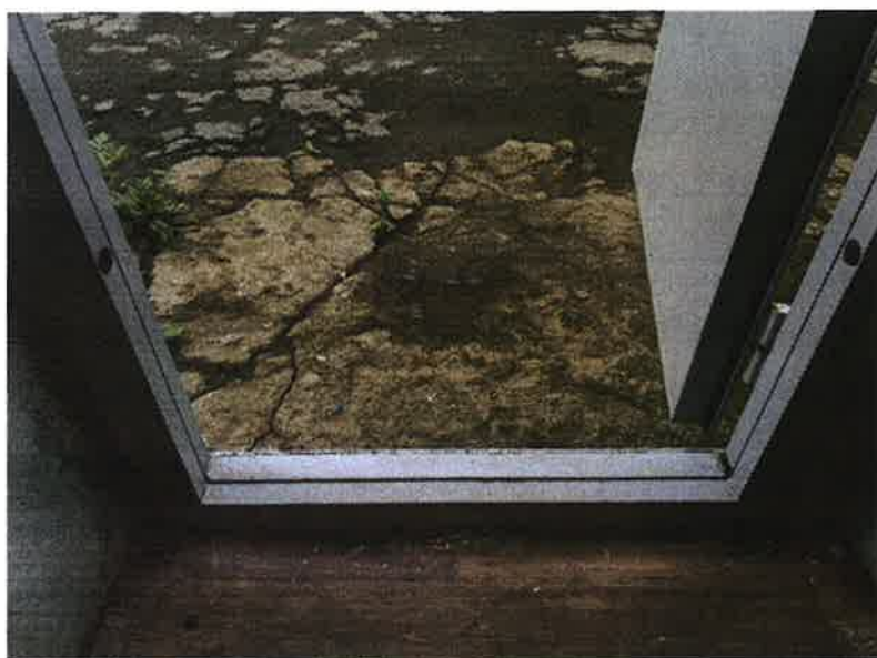
Фото 3.26 Порог двери эвакуационного выхода
