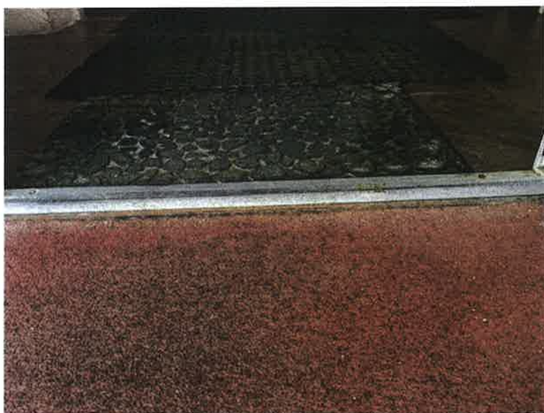
Фото 2.7 Порог входной двери
