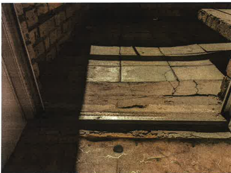
Фото 3.29 Порог двери эвакуационного выхода
