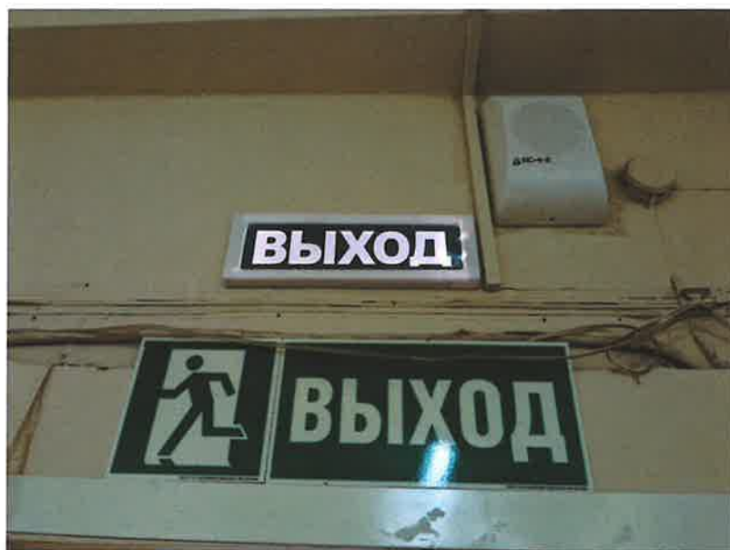
Фото 6.9 Табличка над эвакуационным выходом и звуковой оповещатель
