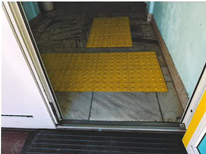
Фото 2.6 Порог входной двери
